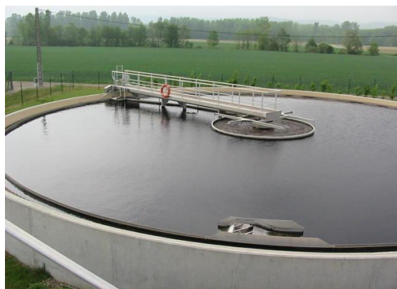
le bassin clarificateur
