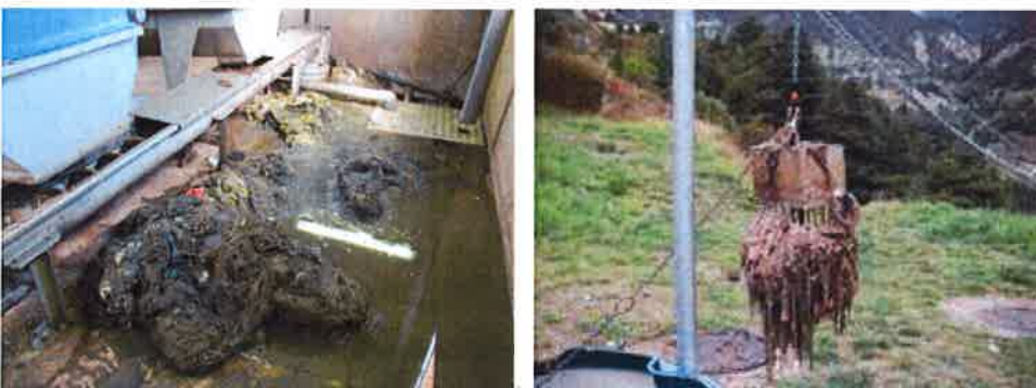
Lingettes agglomérées à la station d'épuration et dans un poste de relevage
